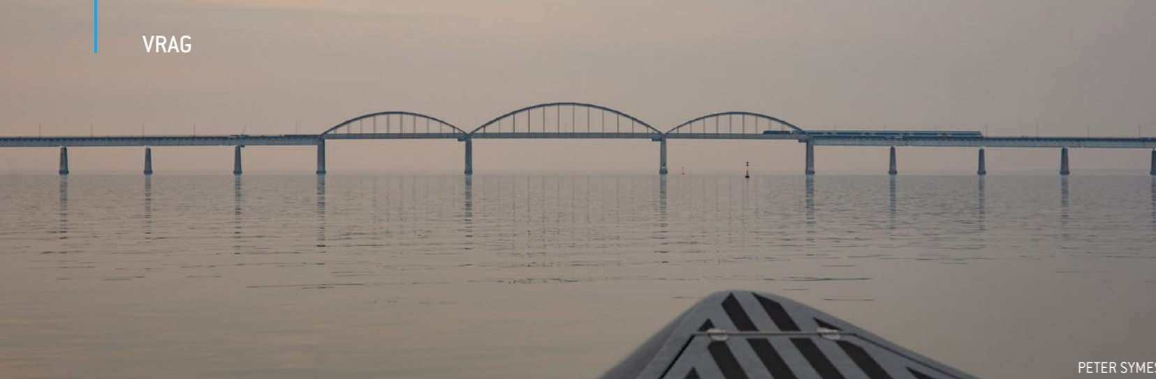
Storstrømmen og broen fra 1937, som er rusten og vil snart blive erstattet af en ny, der bygges ved siden af.
